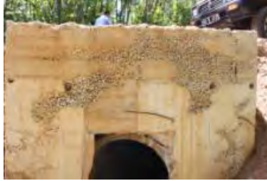
Şekil 2. Drenaj yapılarında malzemenin eksik kullanılması
